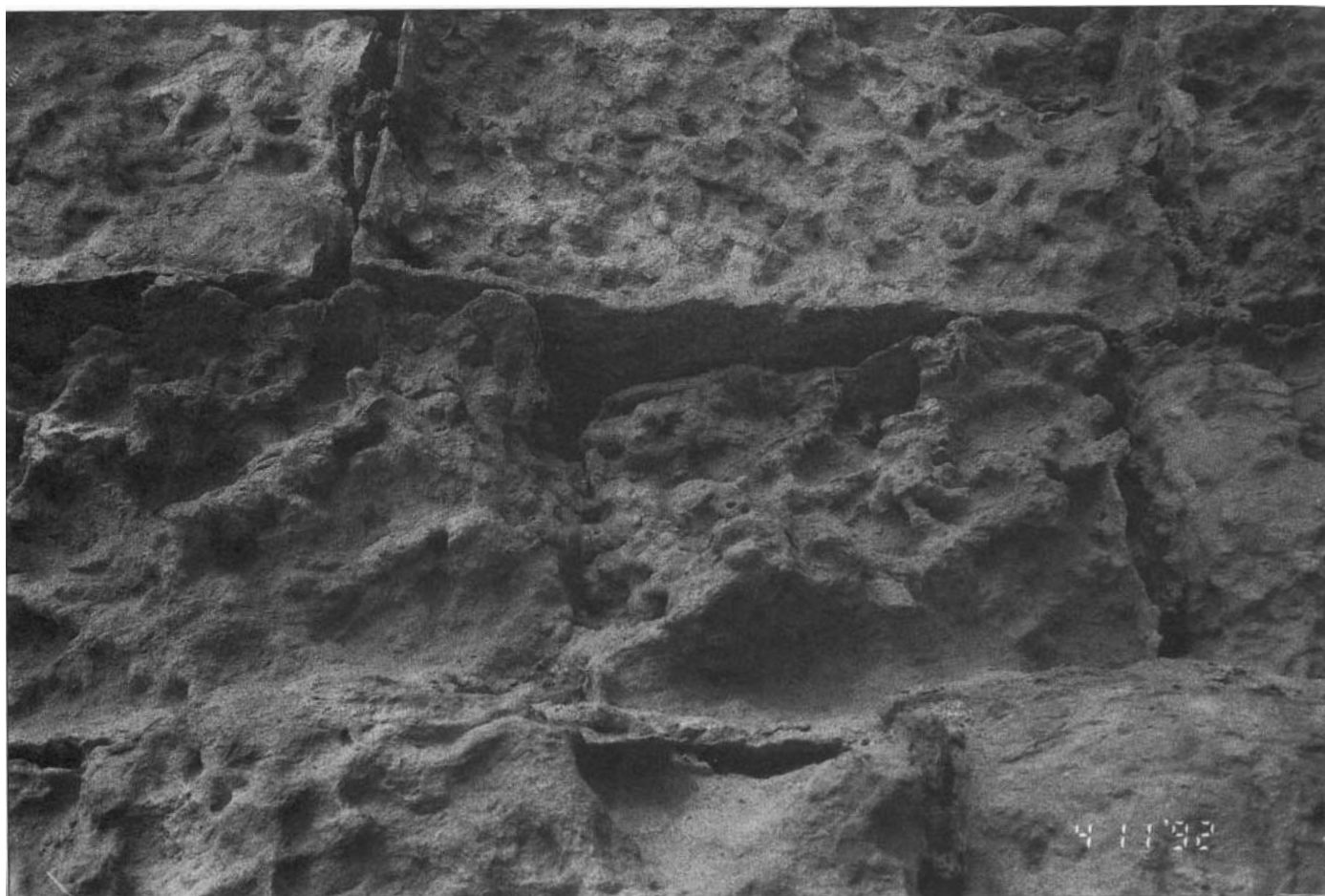
Figura 1.- Sillares alterados de la calcisiltita tipo "Llorito" de la muralla de Tarragona, sector del Paseo San Antonio.
