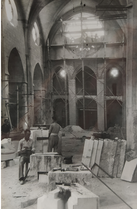
Fig. 9. Obres de consolidació de l'església (1935), @Arxiu documental del Servei de Patrimoni Arquitectònic Local de la Diputació de Barcelona.
